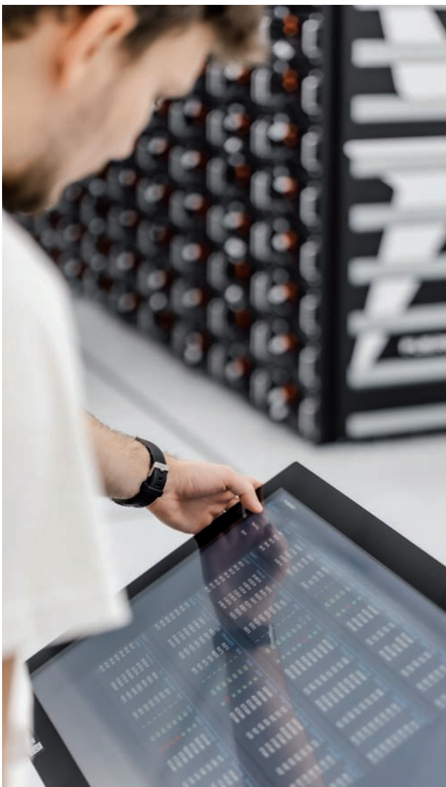
Priamo na mieste má obsluha k dispozícii prehľadný interaktívny panel s aktuálnymi údajmi o výkone a stave úložiska.
