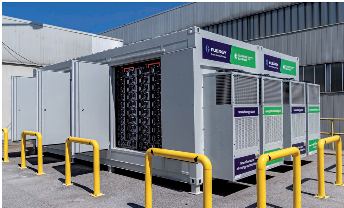
Úložisko je umiestnené v exteriéri v dvoch lodných kontajneroch v blízkosti existujúcej trafostanice
