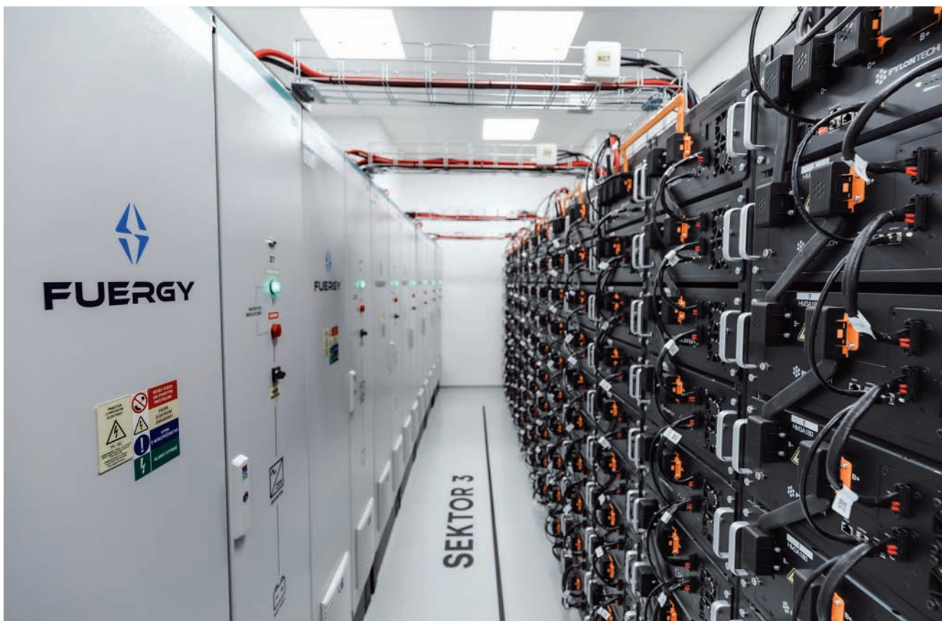
Interiérové batériové úložisko brAln by FUERGY spolu s meničmi v klimatizovanej miestnosti rozvodne
