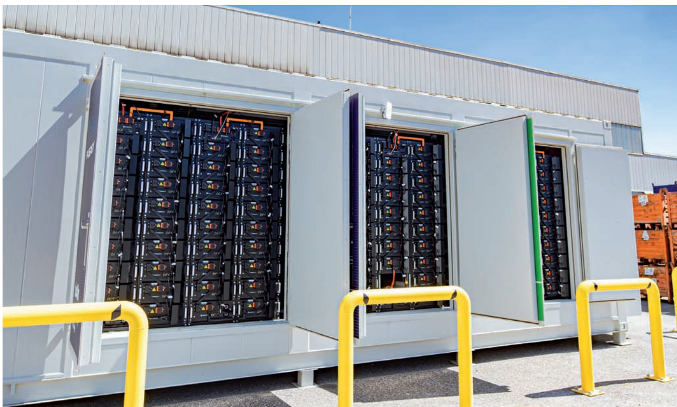
Embraco Slovakia využilo pri inštalácii úložiska model „Energia ako služba“, ktorú svojim zákazníkom prináša spoločnosť Slovenské elektrárne – energetické služby, s.r.o.
