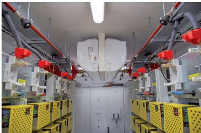
Batériové úložisko MES – pohľad do kontajnera
